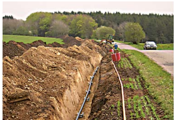
Exempel på kabeldragning vid väg.
